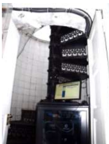
Figura 31. Cámara de servicio (Faro de La Plata).
