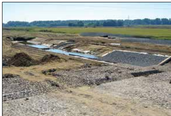
Cigánd: az épülő árapasztó víztározó. Jelentős tájformáló hatása volna, ha rendszeresen víz alá kerülne a gátak által körülvett, Velencei-tóhoz hasonló nagyságú terület (2008. augusztus)
