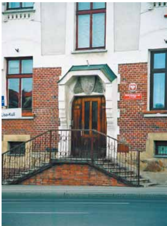
Obniżenie poziomu ulicy Zamkowej w 1940 roku wymusiło budowę schodów do drzwi wejściowych
