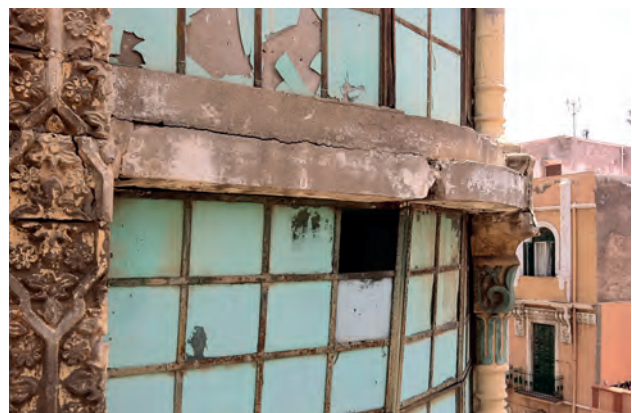
(Figura 3) Detalle del estado de los cierres y cristalerías.
