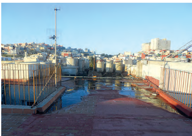
(Figura 4) Estado de la azotea del edificio.
