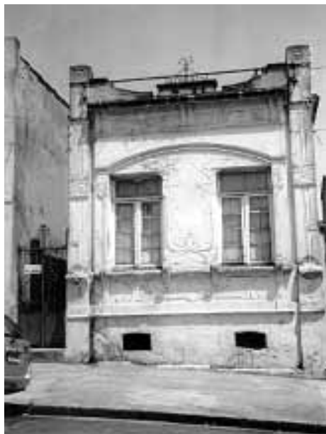
Foto 5 - Imóvel deteriorado tipo capomastri – rua Vitorino Carmilo nº 933
