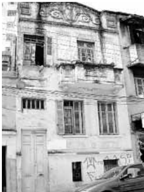
Foto 6 - Imóvel deteriorado tipo capomastri – rua Lopes de Oliveira nº 449
