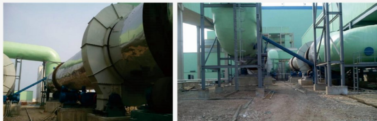
恒力石化集团. 长兴岛厂区-低温余热污泥干化总包工程
