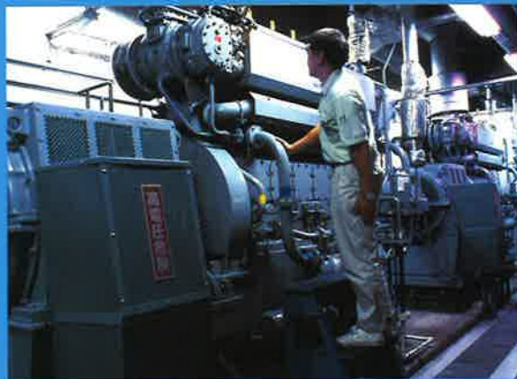
自家発電機の点検
