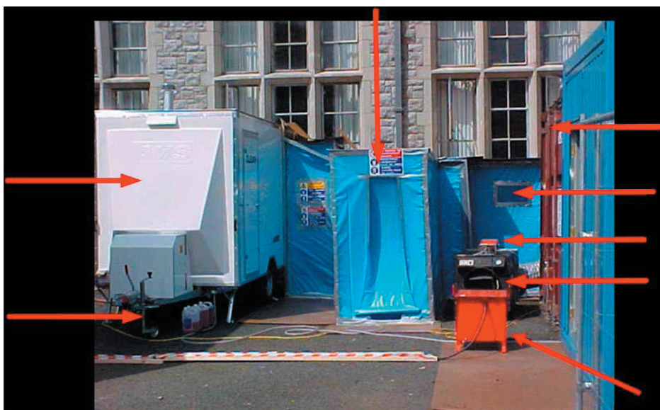
Obrázek 12.1: Vstup do uzavřeného prostoru; šipky odshora po směru hodinových ručiček ukazují na: přechodovou komoru na pytle, kontejner na odpad, průzor, tlakoměr na měření podtlaku, podtlakovou jednotku, přívod elektřiny, zásobu smáče del a dekontaminační jednotku.
