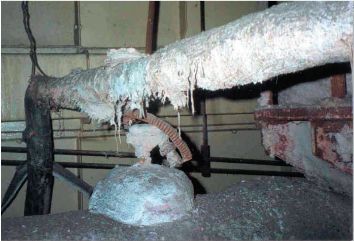
Obrázek 4.8: Azbestová izolace na parovodním potrubí.
