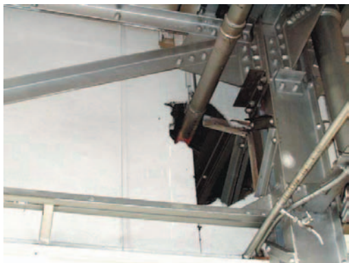
Obrázek 4.3: Příčka z azbestové izolační desky. Na tomto příkladu jsou vidět praktické problémy spojené s vybudováním vhodného uzavřeného prostoru a také plochy, na nichž se během odstraňování azbestu může usazovat azbestový prach.
