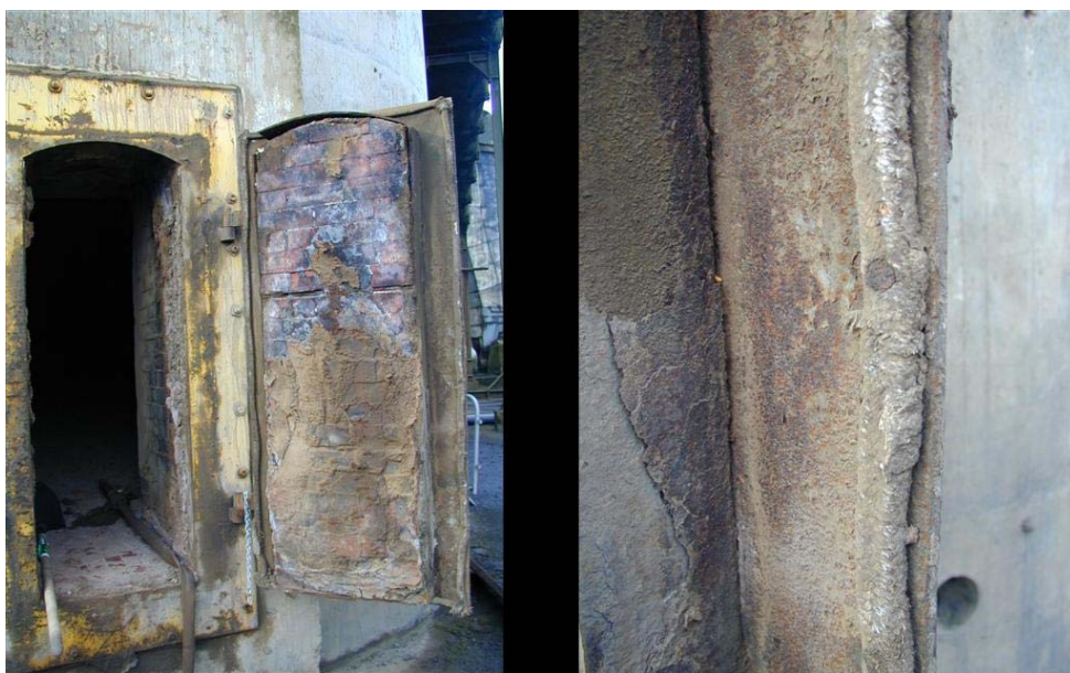
Obrázek 4.12: Komínová dvířka s těsněním z azbestových provazců. Vpravo je detailní snímek provazce.
