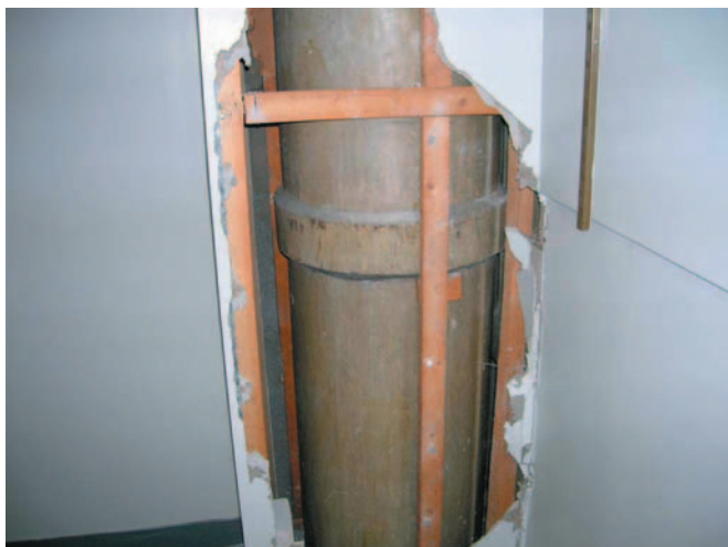
Obrázek 4.2: Azbestocementová kouřová trubka, která je vidět pod částečně odstraněným pláštěm z azbestové izolační desky.
