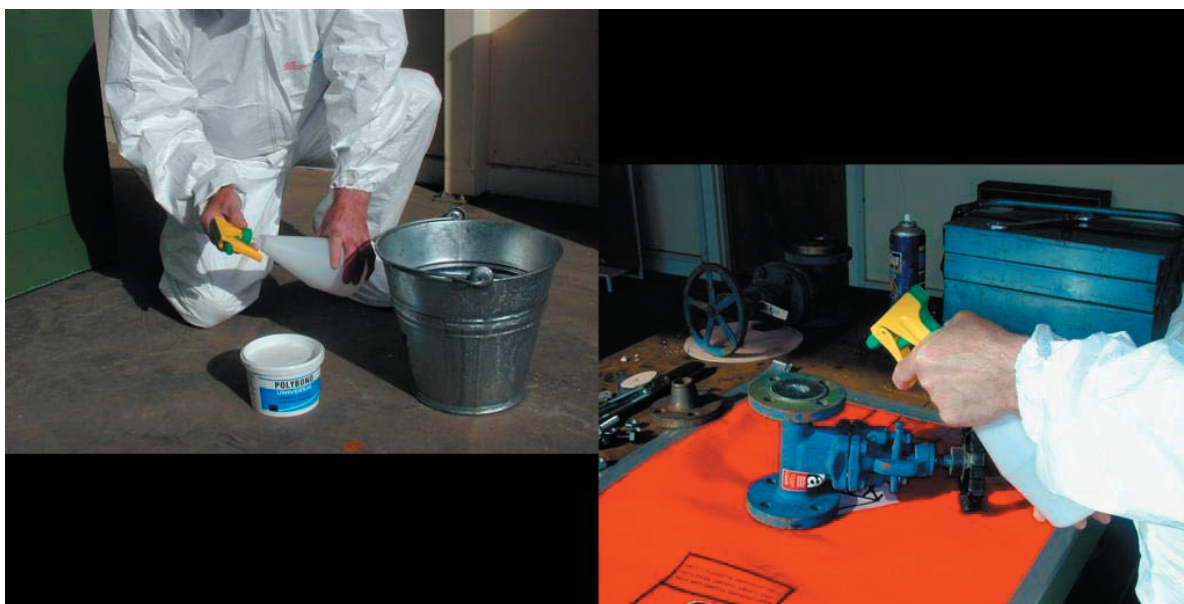
Obrázek 11.4: Navlhčení azbestového těsnění na ventilu.
