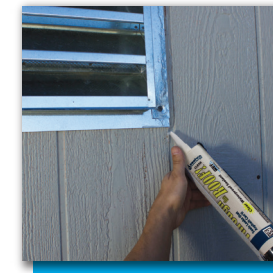
Rejillas de ventilación
