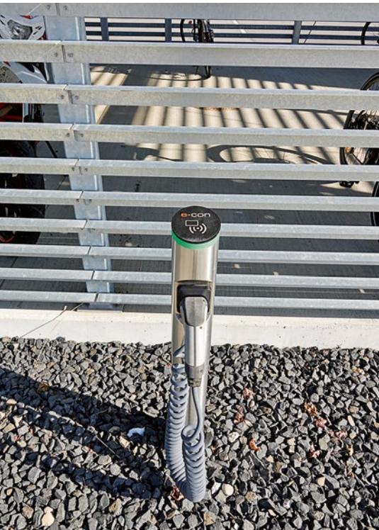
Die einfachen Ladesäulen dienen für den Bedarf an Ladestrom für die Mitarbeiter
