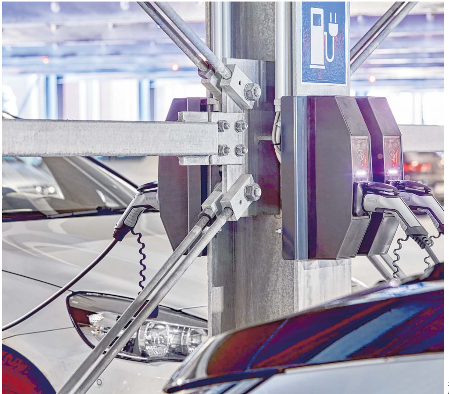
Parkhaus von Bechtel in Neckarsulm: 120 Ladepunkte stehen den Dienstwagenfahrern zur Verfügung.
