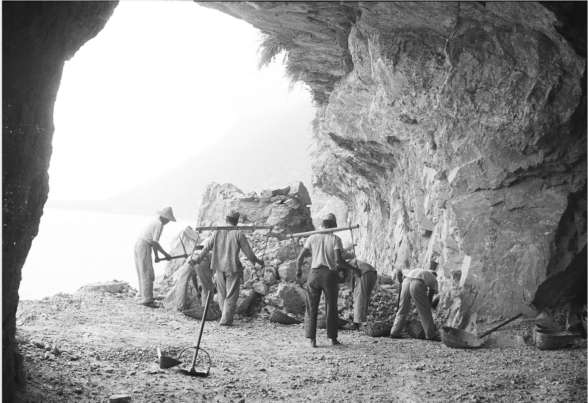
圖 03：〈人工搶修蘇花公路坍方災害道工清除作業〉。圖片提供者：交通部公路總局第四區養護工程處。網站名稱：數位島嶼。
