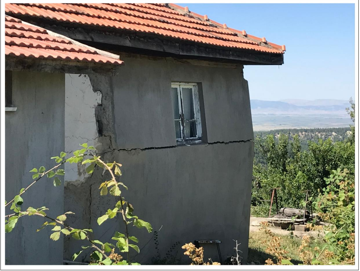
Şekil 7. Armutalanı Mahallesiinde deprem nedeniyle oluşan hasarlar
