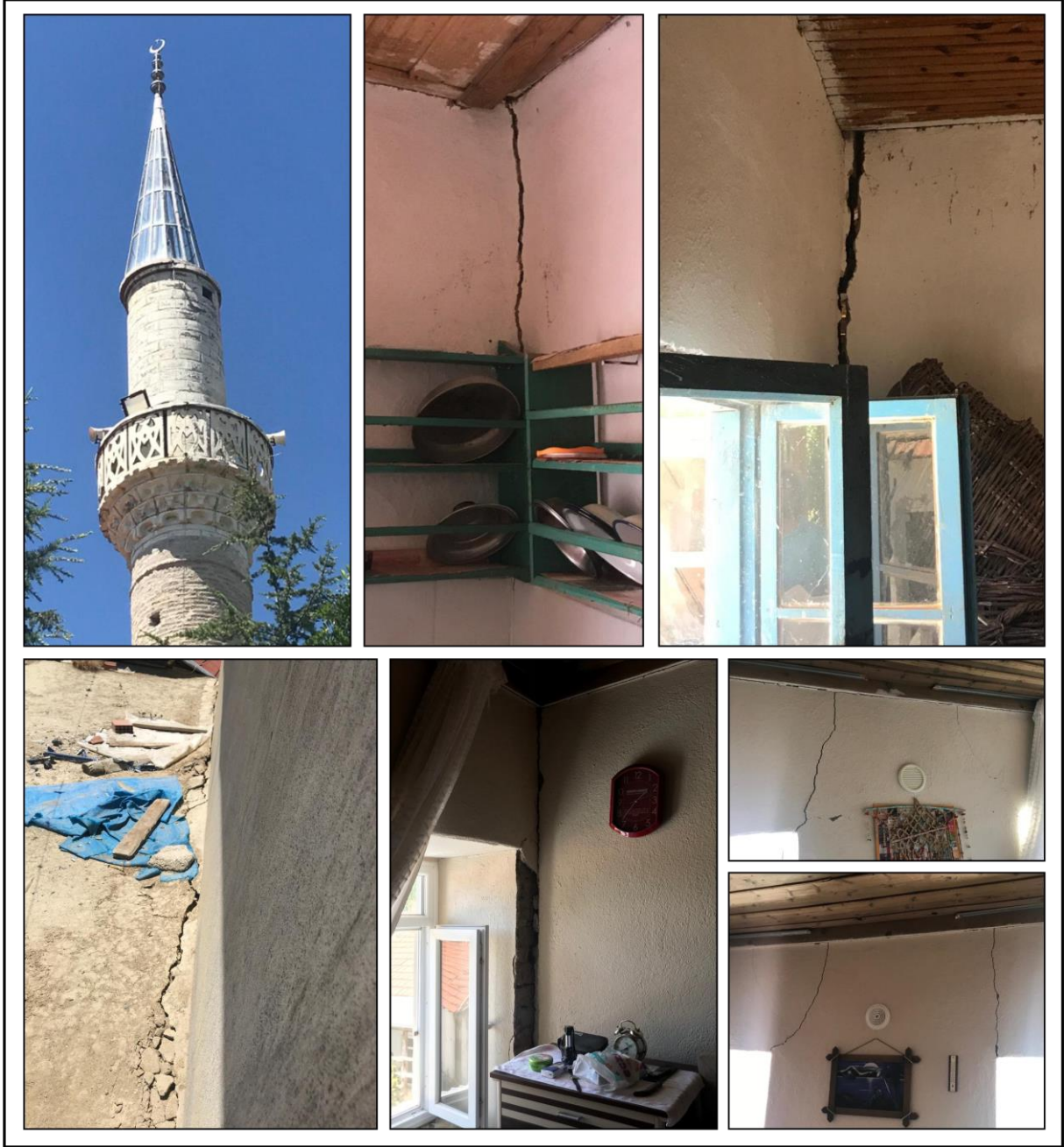
Şekil 6. Dutluca Mahallesiinde deprem nedeniyle oluşan hasarlar
