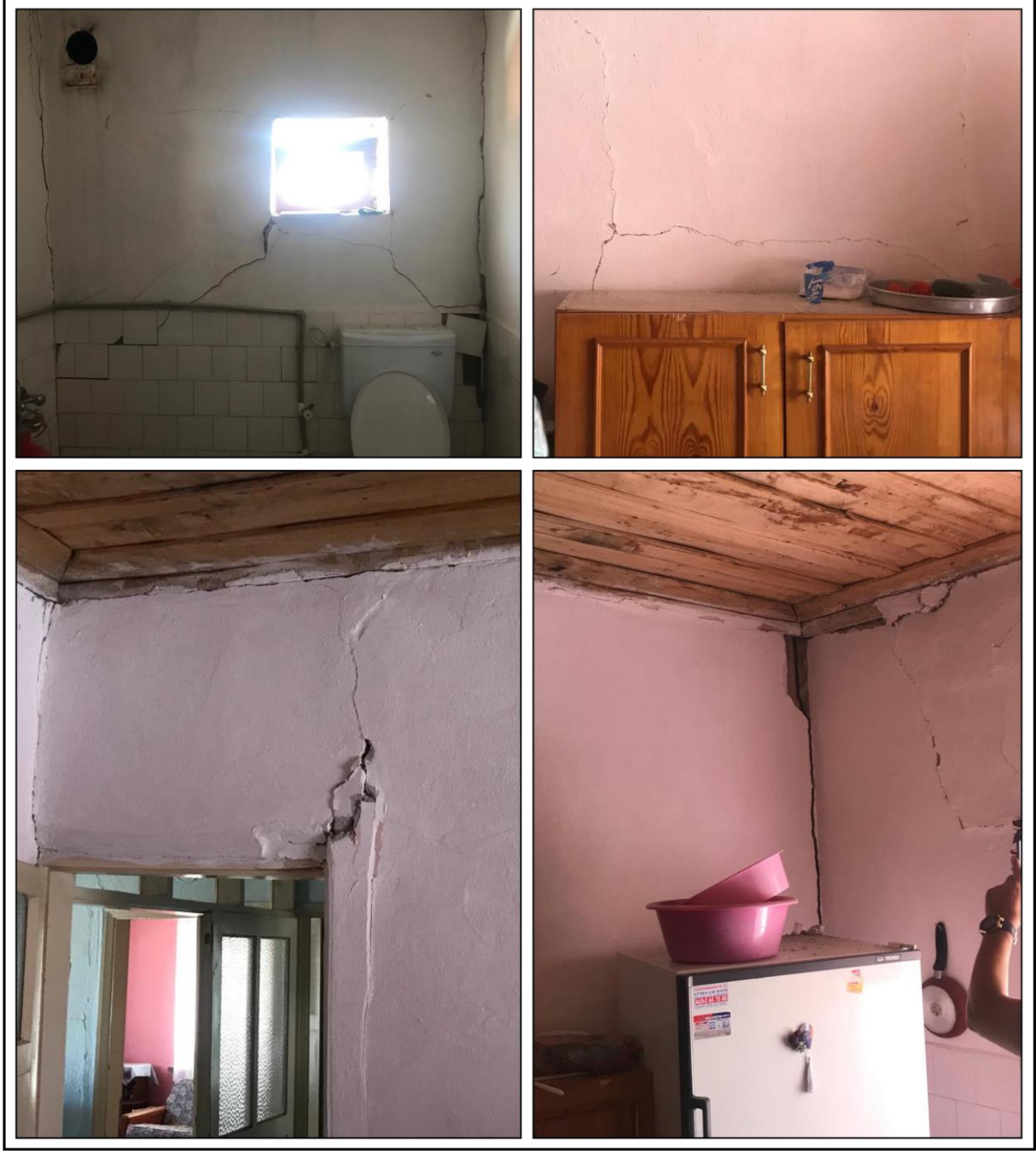
Şekil 5. Dutluca Mahallesinde deprem nedeniyle oluşan hasarlar
