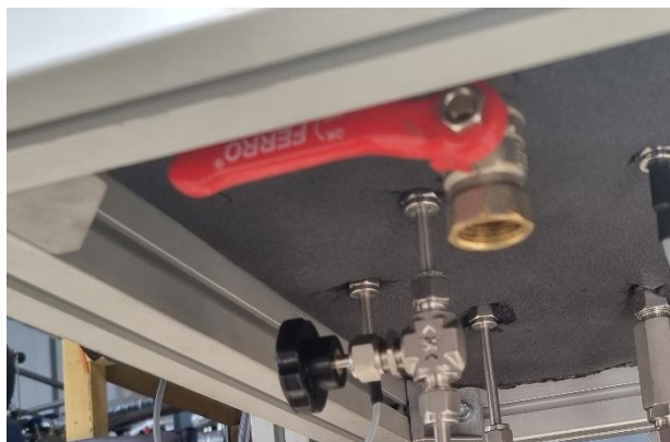
Obrázek 88: Drain chladicí nádrže
