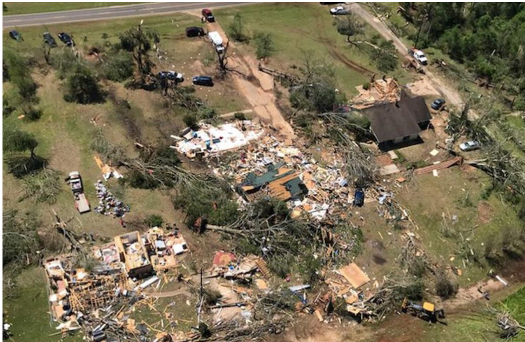
Figura 3-48: Daño a zona residencial por tornado en el condado Cherokee, tornados de abril de 2019. 234
