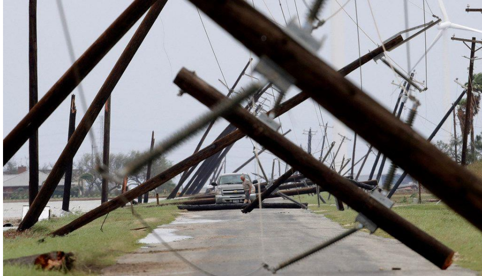
Hình 3-32: Hệ thống đường dây bị đứt sập gần Taft, Texas, trong Siêu bão Harvey. 125
