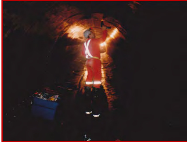
Les fissures et les joints de construction dans les structures d'eau potable sont scellés de façon permanente à l'aide de la résine 'MME FLEXIBLE RESIN'.
