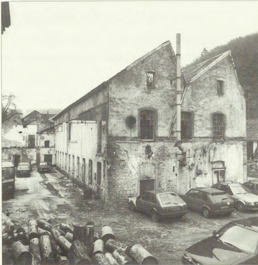
Die Bausubstanz verfällt (Photos: Jochen Herling)
