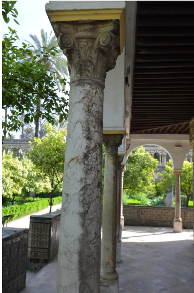
Fotografía nº 7 Columnas ennegrecidas en el interior por la combinación de agua y partículas de polvo.
