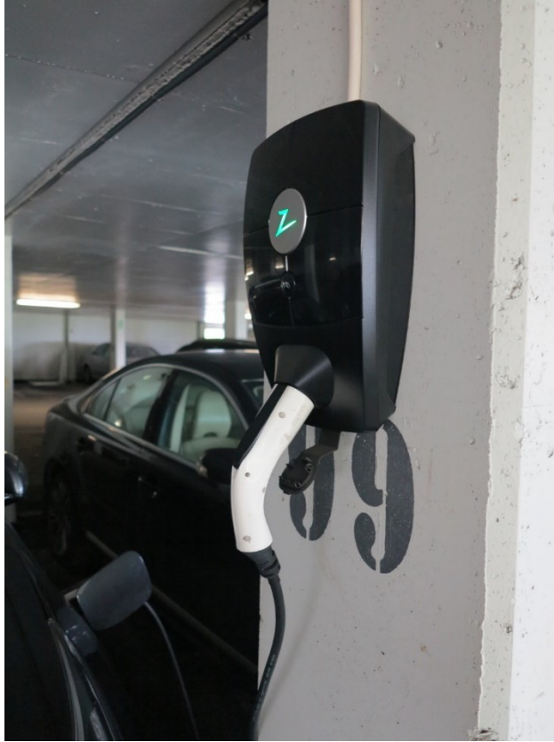
Bild 3-7 Alla laddboxar i garaget kommer från samma leverantör och är en del av det dynamiska laddsystemet.
