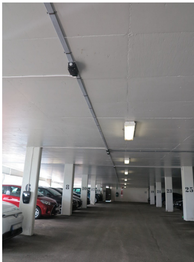
Bild 3–5 Två huvudkablar på varje våning förser laddboxarna med el (platt kabel i taket, mitt i bilden). Från huvudkablarna dras det ledningar till laddboxarna. Elanläggningen har kapacitet för att alla parkeringsplatser ska kunna ansluta till laddsystemet. Bilägarna väljer själva om de vill ansluta till systemet, men om fordon ska laddas i garaget måste de ansluta till systemet.
