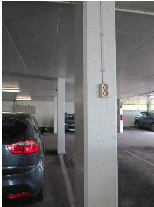
Bild 3–4 Innan laddboxarna installerades användes uttag för motorvärmare för elbilsladdningen. Sedan laddsystemet installerades har ett förbud mot att ladda bilar via stickkontakter införts.
