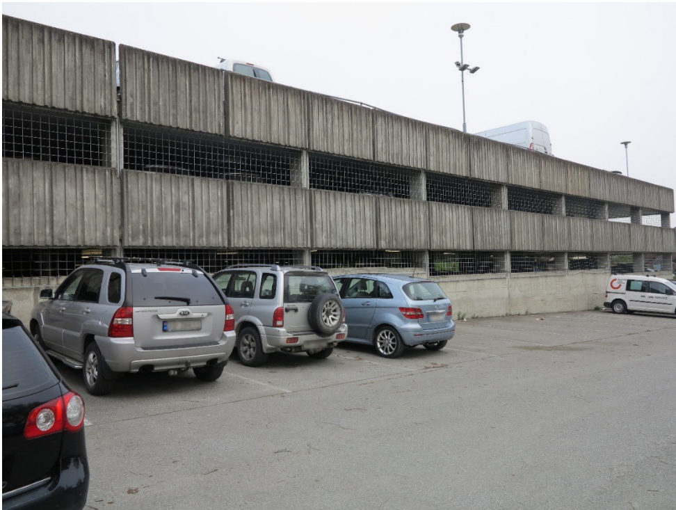
Bild 3–1 Delat garage på två våningar med gästparkering på taket. Garaget är fristående.
