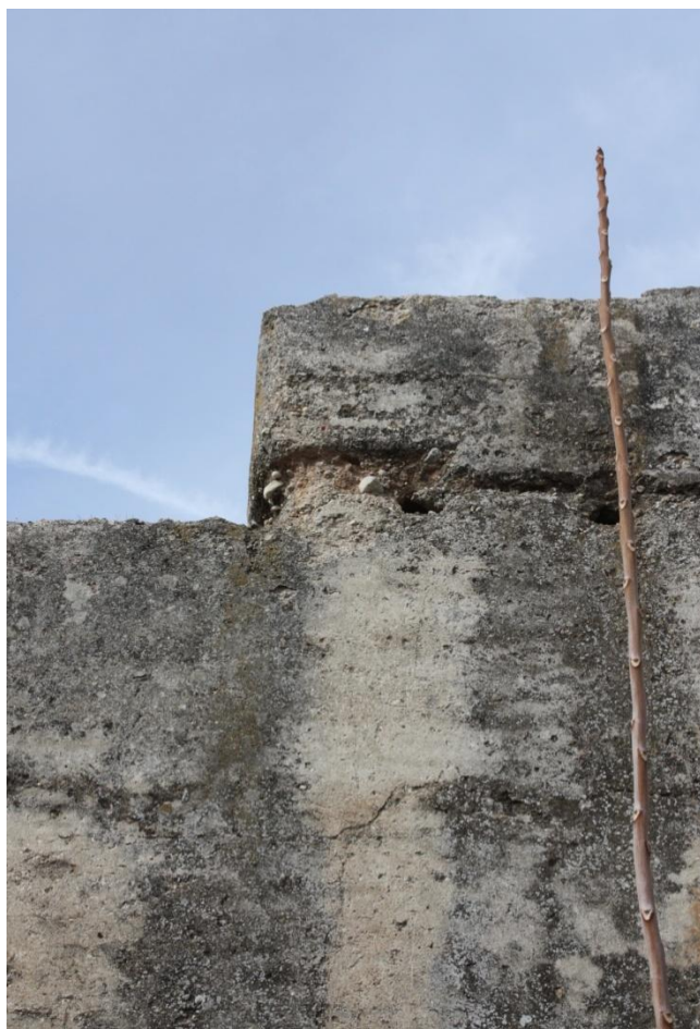
Figura 4.47. Escalonamiento en la última hilada. Véase la posición de una aguja en el plano del escalón para instalar costales y permitir el apriete de la frontera. Véase también paramento con pátinas anaranjadas (a) y restos de musgos y líquenes (b)
