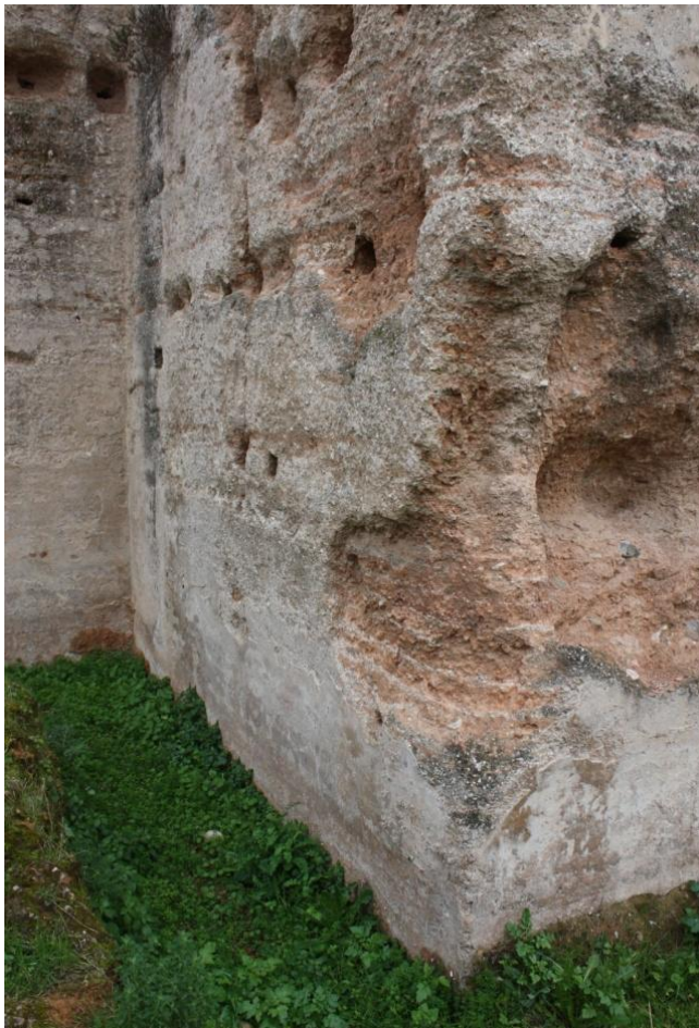
Figura 4.9. Esquina de la torre E. La pérdida de la costra superficial permite distinguir las diferentes tongadas así como la profundidad del deterioro
