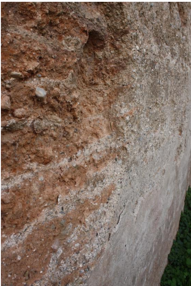
Figura 4.8. Detalle de paramento en torre E. La pérdida de la costra superficial permite distinguir las diferentes tongadas así como la diferencia de materiales
