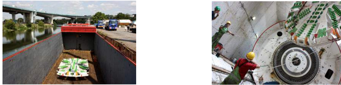
Figure 33 : Acheminement et assemblage du tunnelier Source : Site du prolongement de la ligne de métro 12
