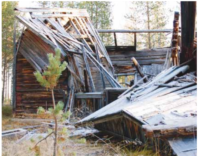
Efter att gården stått öde i mer än 60 år har även mangårdsbyggnaden gett upp.
