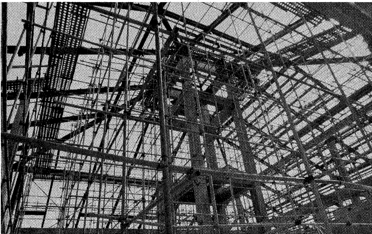
쌍용건설이 현재 용산정문앞에 건설중인 클럽의 지붕공사를 하기위하여 설치하여 놓은 받침대를 올려다 본 모습. 이 공사는 내년엔 완공될 계획이다.
