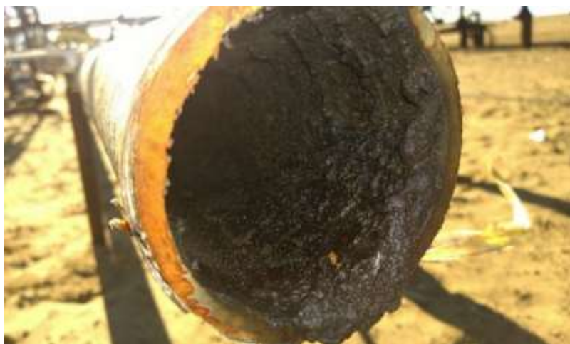
Рис. Отложения парафина в наземных нефтепромысловых коммуникациях
