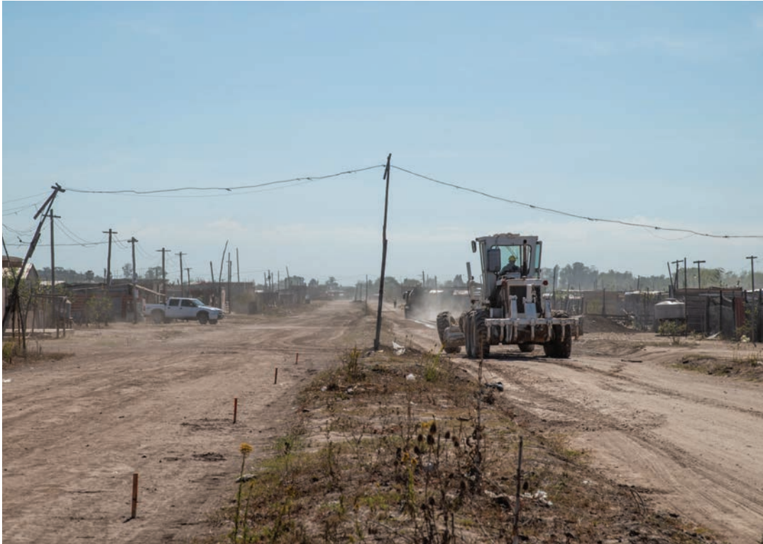
Apertura de calles en trabajo conjunto con la gobernación de la Provincia de Buenos Aires.
