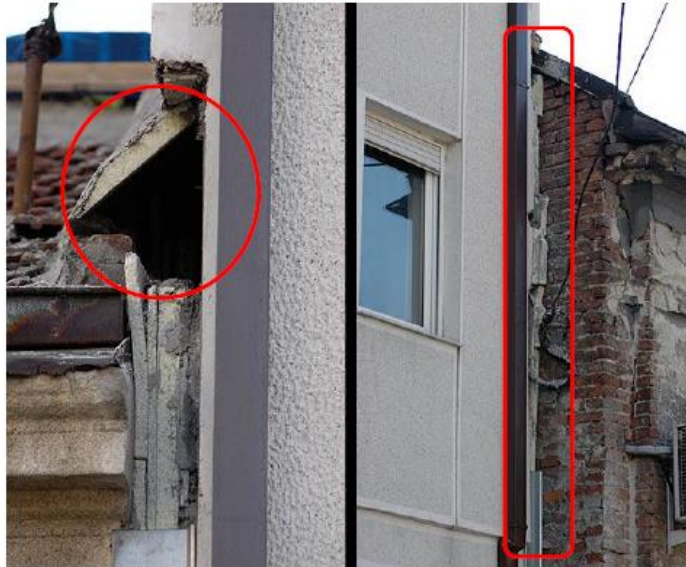
Слика 8: Пример лоше изведене топлотне изолације 32
