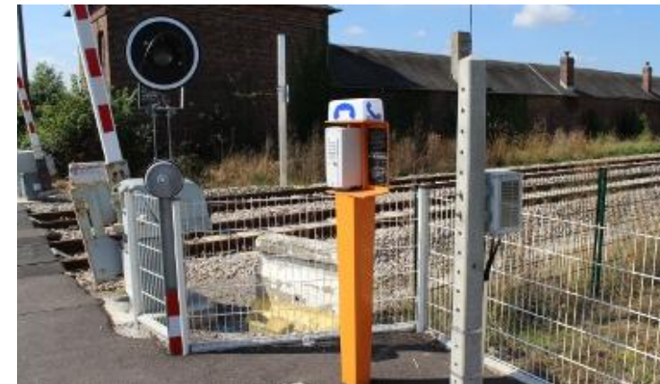
Figure 71. Téléphone de passage à niveau en abri type autoroute
