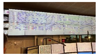
Centre de commandement de Saint Denis
