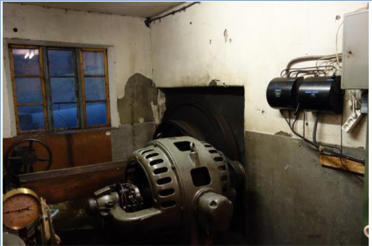
Figur 23. Lesjaverk gard, interiør med generator (frå kraftverket). (Foto: Lesja kommune)
