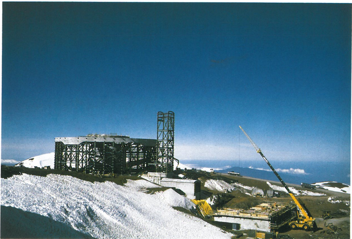
図4 マウナケア山頂工事。ドーム下部鉄骨、エレベータタワー、制御棟などが立ち上がっている。
