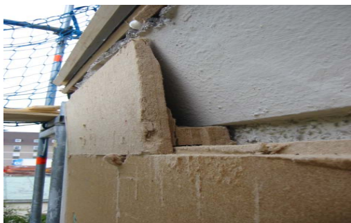
Bild 5: Wärmebrücke im Traufbereich! Holzweichfaser-WDVS wurde unsachgemäß angebracht, Detailaufgabe schlampig gelöst.
