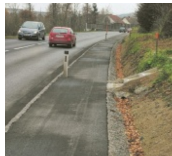
Der Gehsteig wies bereits seit geraumer Zeit erhebliche Mängel auf.
