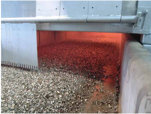
Bild 3: Blick in die Trocknerrinne.
